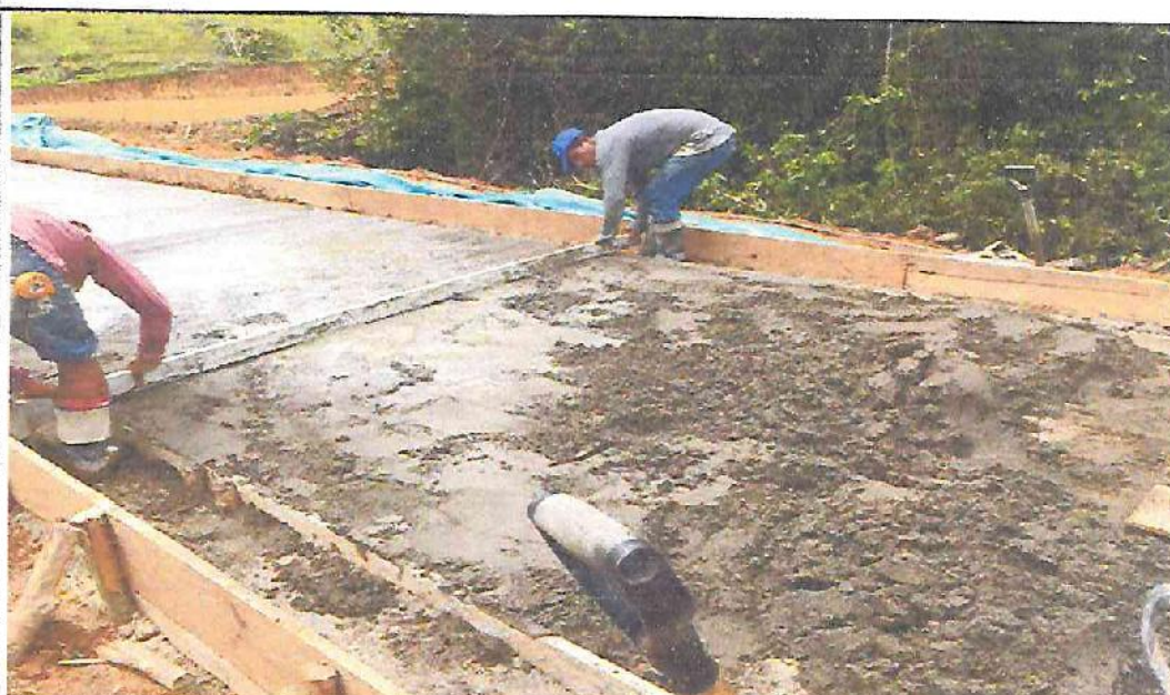
MEJORAMIENTO DEL SERVICIO DE TRANSITABILIDAD VIAL EN LOS CENTROS POBLADOS SANTA CLOTILDE, SAN ANTONIO FERNANDO LORES Y HUIRIRIMA-DISTRITO DE NAPO-PROVINCIA MAYNAS- DEPARTAMENTO LORETO
