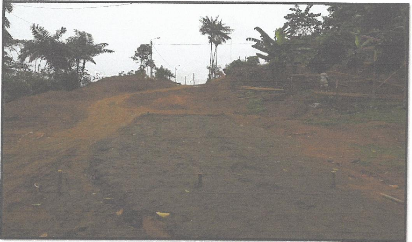
Imagen 17: Implementación de ejes y hombros para la ubicación y coordenadas de la carretera.
